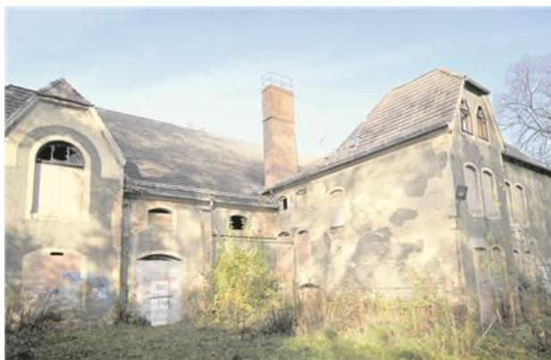
Privates Engagement oder Gemeinsinn? Wie sich die Jahnhalle retten lässt, darüber wird in Meissen debattiert. Fakt ist: Lange darf sie nicht mehr dem Verfall preisgegeben werden. Foto: Archiv/C.Hübschmann
